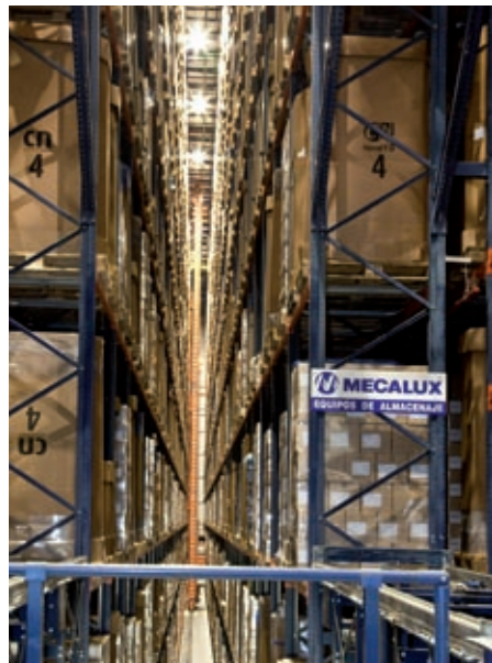
Pasillo de almacenaje con transelevador.
