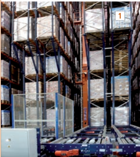
En el silo automático se almacenan los productos de más rotación.
