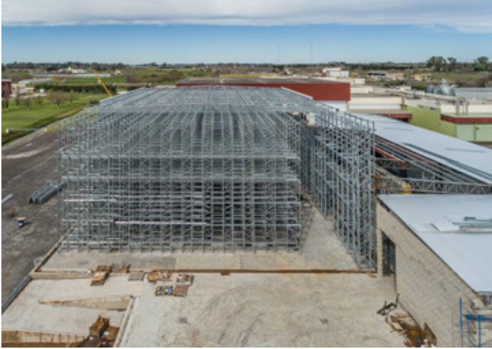
Almacén autoportante con cámara para producto congelado.
